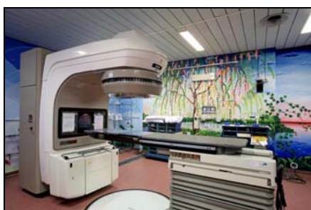
Sala bunker con l'Acceleratore Lineare
